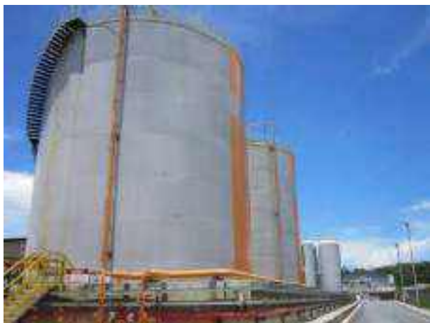
Figura 2.10: Tanques de armazenamento de ácido sulfúrico
