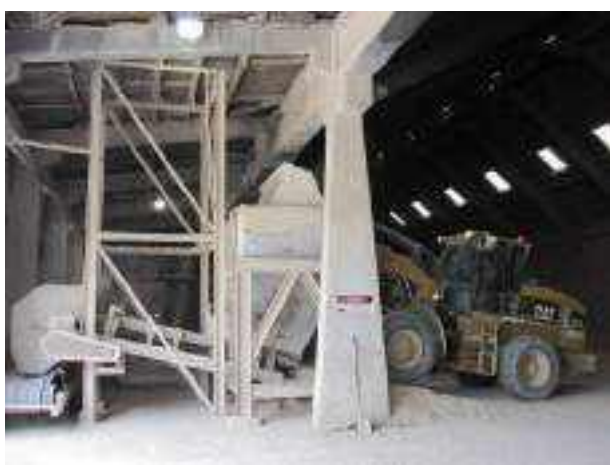
Figura 2.18: Alimentação da moega de matérias primas da granulação via pá carregadeira
