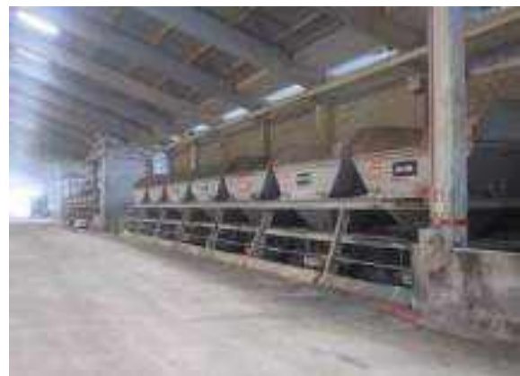
Figura 2.2.3.4-4: Vista detalhe das moegas automáticas das Misturas 4 e 5
