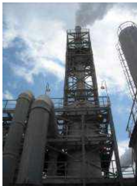
Figura 2.2.5.2-31: Vista do último estágio de lavagem (torre com recheio) e chaminé de saída dos gases
