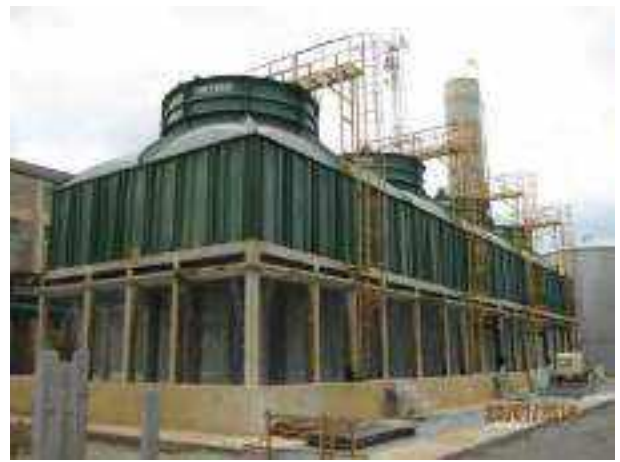
Figura 3.11: Torre de resfriamento da unidade de sulfúrico
