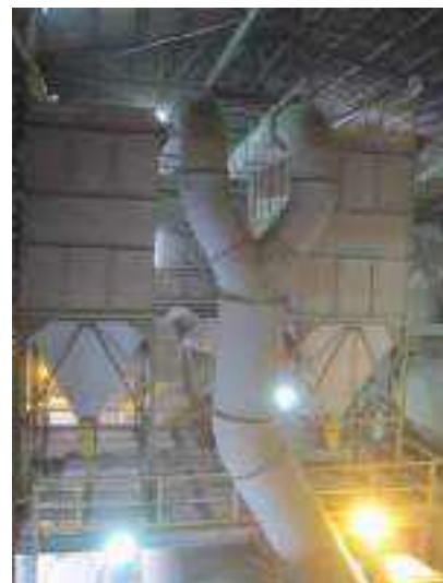
Figura 2.21: Vista geral dos dois filtros de manga do sistema de exaustão do resfriador
