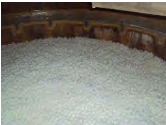
Figura 19 - Demister - parte interna
