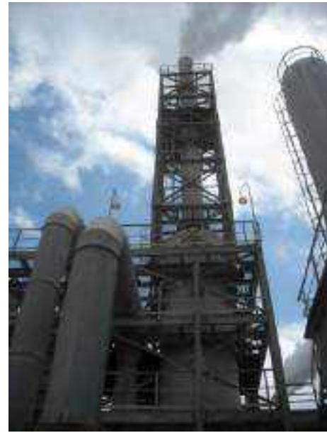
Figura 2.17: Detalhe da chaminé do lavador de gases da acidulação
