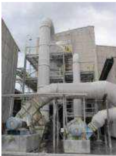
Figura 2.20: Vista geral dos corpos lavadores e exaustores para os gases do granulador e secador.
