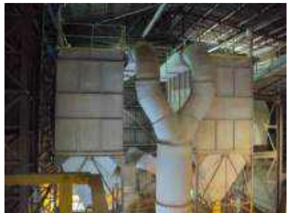
Figura 2.2.5.2-39: Vista dos Filtros de Mangas do Resfriador de Gases instalados e em operação
