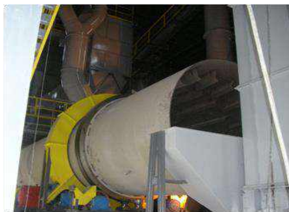
Figura 2.2.3.3-7: Vista geral da saída do Resfriador e bica de entrada do produto no Elevador de Canecas e ao fundo os Filtros de Mangas do Resfriador
