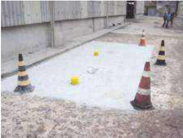
Figura 2.5.4-7: Novo sistema de fossa filtro anaeróbio (FFA), instalado no sanitário do Setor de Armazéns (SA)
