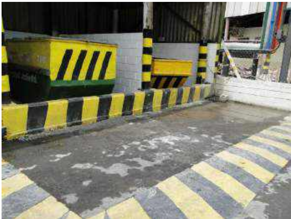
Foto 16: ADTR para resíduos perigosos - vista da bacia de contenção
