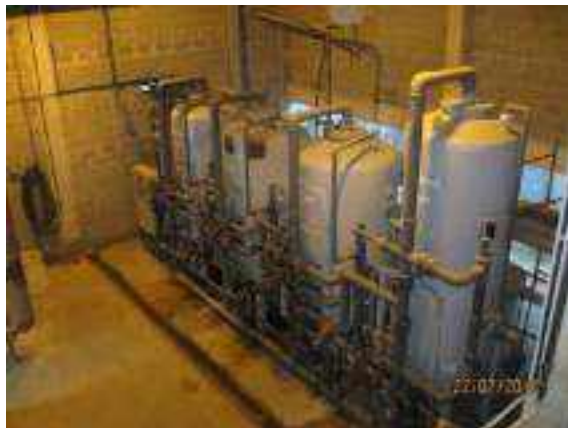
Figura 2.2.3.1-10: Vista geral da unidade desmineralizadora de água
