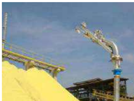
Figura 2.2.5.2-4: Detalhe de um dos canhões de aspersão de água para umectação da pilha de enxofre.
