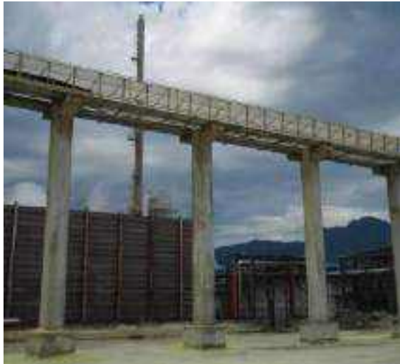
Figura 2.2.5.2-9: Vista da correia de transferência de enxofre aérea sobre o pátio totalmente enclausurada
