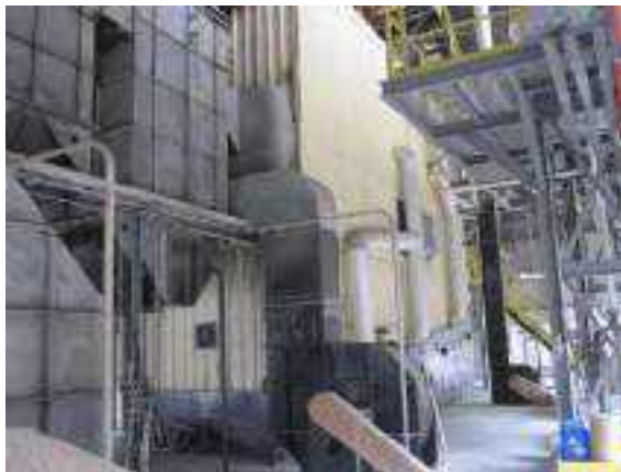
Figura 2.2.3.3-5: Vista geral da fornalha de biomassa e caixa da ciclone na entrada
