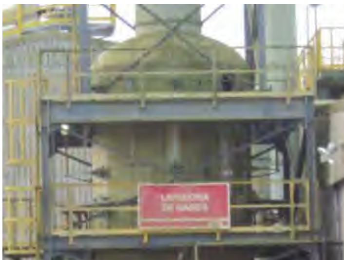
Figura 17 - Demister - vista geral
