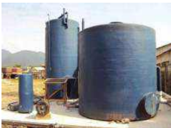
Figura 2.5.4-13: Equipamentos da nova ETE já dispostos no local para instalação
