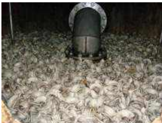
Figura 2.2.5.2-12: Eliminadores de névoas das Torres de Absorção.
