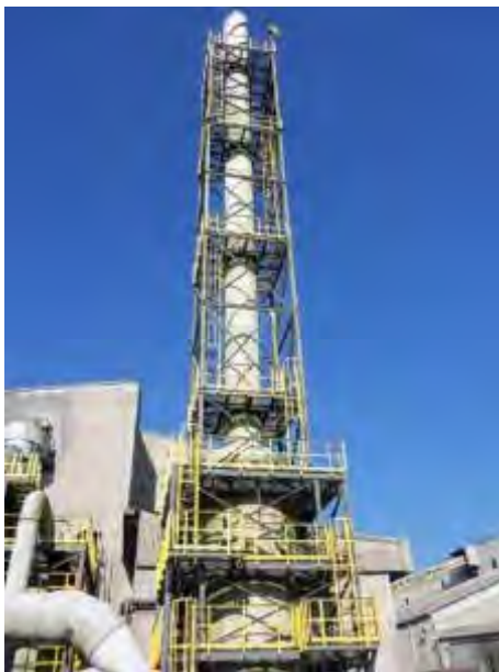
Figura 15 – Demister – vista geral
