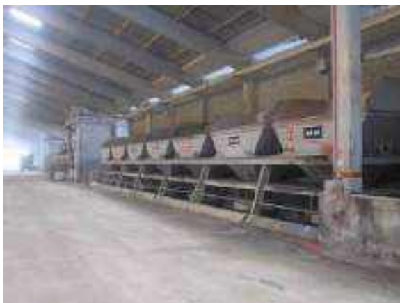
Figura 2.25: Detalhe das moegas automáticas das Misturas 3 e 4
