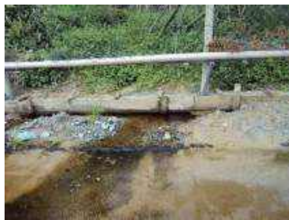
Figura 2.5.4-2: Águas provenientes de área contígua, encaminhadas para o sistema de drenagem do empreendimento
