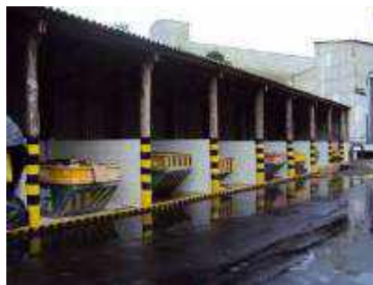
Figura 2.6.2.1-2: Vista das baias de estocagem de resíduos sólidos cobertas e com diques de contenção da ADTR
