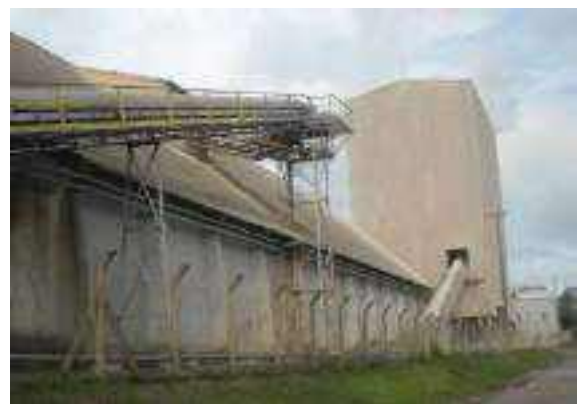
Figura 2.2.5.2-20: Vista geral das correias externas de transporte de rocha devidamente enclausuradas
