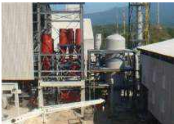
Figura 2.2.4.1-13: Implantação da ciclonagem e lavador de gases da Granulação (jul/2008).
