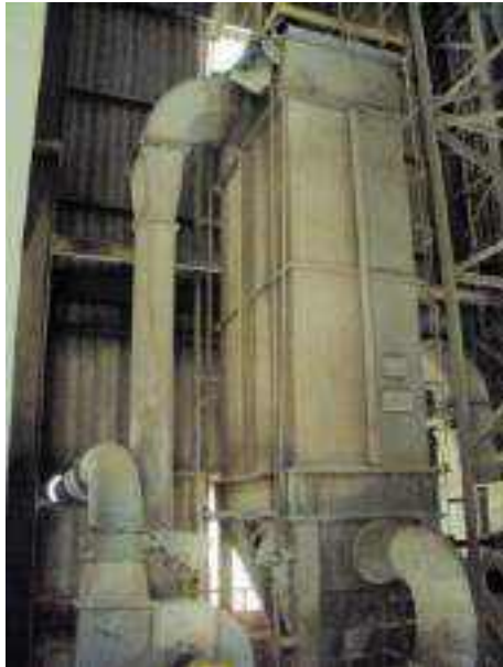
Figura 2.2.5.2-26: Vista geral do filtro de mangas do despoejamento da área da moagem
