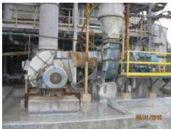
Figura 2.2.5.2-32: Vista dos Exaustores do lavador de gases da Acidulação
