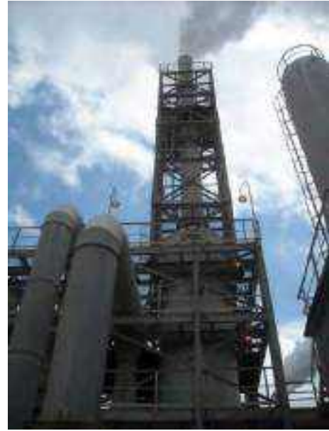
Figura 3.17: Detalhe da chaminé do lavador de gases da acidulação
