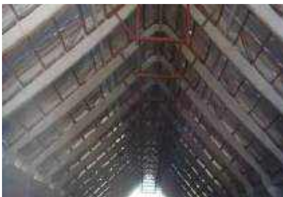
Figura 2.2.5.2-19: Vista interna do telhado do armazém de rocha. Enclausuramento com manta impermeabilizante – foto da época da montagem
