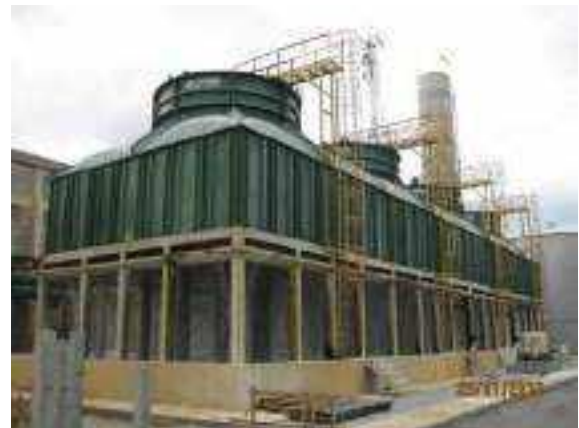
Figura 2.2.3.1-11: Torre de resfriamento da unidade de produção de ácido sulfúrico
