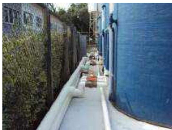
Figura 2.5.4-14: Nova ETE já instalada no local aguardando autorização do IAP para operação
