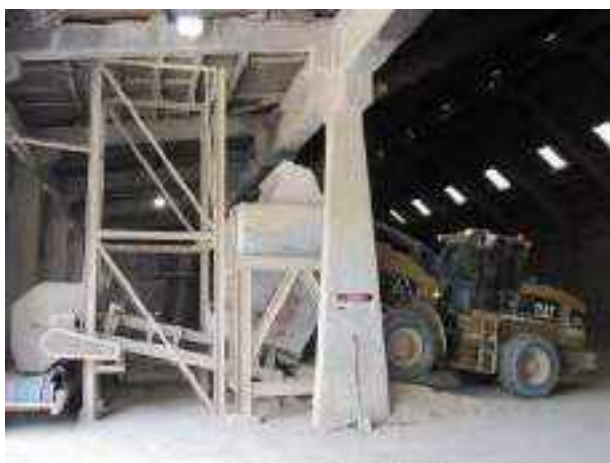
Figura 3.18: Alimentação da moega de matérias primas da granulação via pá carregadeira
