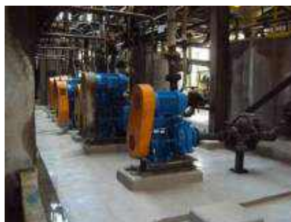
Figura 2.2.5.2-33: Vista das bombas de recirculação de lavagem instaladas em dique de contenção impermeabilizado
