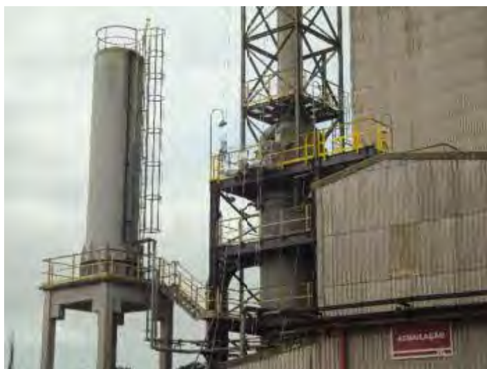
Figura 16 - Demister - vista geral na unidade de acidulação
