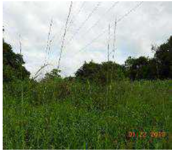
Figura 4.2.1.3.9-6: Vegetação antropizada (campo antrópico) se desenvolvendo sob Linha de Transmissão, na região sudeste da AID.
