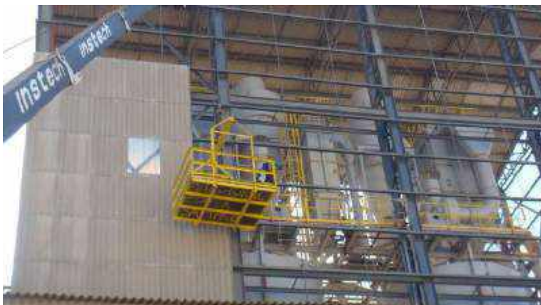
Figura 2.2.5.2-25: Vista geral dos filtros de mangas instalados na área de moagem – Foto da época da construção da fábrica. Posteriormente, o prédio foi fechado, conforme mostra a parte esquerda da foto.
