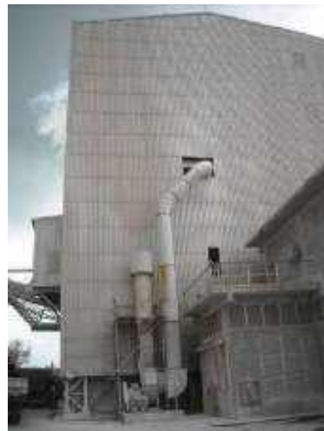
Figura 2.2.5.2-41: Duto de saída, exaustor e chaminé do filtro de mangas do sistema de despoeiramento da granulação
