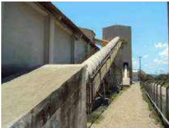
Figura 2.2.5.2-17: Vista das correias transportadoras de rocha enclausuradas (fora dos galpões)
