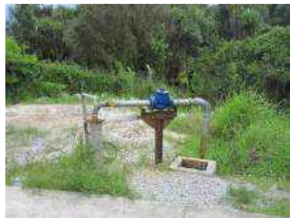
Figura 2.2.3.1-13: Poço artesiano de captação de água subterrânea
