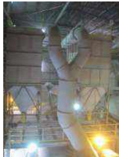
Figura 3.21: Vista geral dos dois filtros de manga do sistema de exaustão do resfriador
