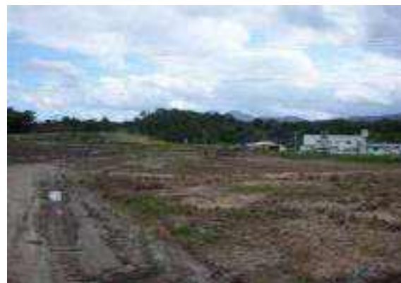
Figura 2.2.4.1-4: Vista geral da etapa de terraplanagem da área para implantação das misturas (jan/05).
