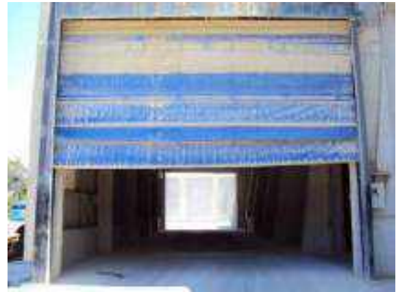
Figura 2.2.5.2-16: Vista do detalhe da porta de fechamento do galpão de recebimento de rocha. Ao fundo porta de contenção de poeiras aberta
