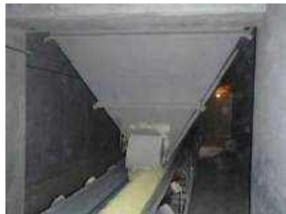
Figura 2.2.5.2-8: Vista da descarga de moega em correia transportadora de enxofre em túnel de concreto evitando emissões
