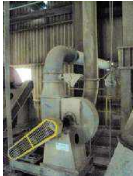
Figura 2.2.5.2-27: Vista geral do exaustor do filtro de mangas do despoejamento da área da moagem
