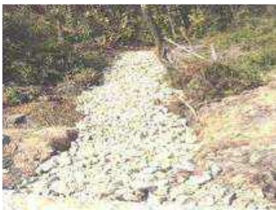
Figura 2.5.4-5: Obras de drenagem para segregação das águas pluviais provenientes de área contígua ao site da empresa
