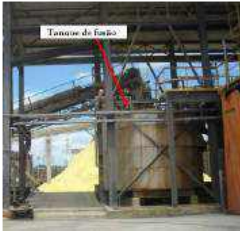
Figura 2.7: Tanque de fusão
