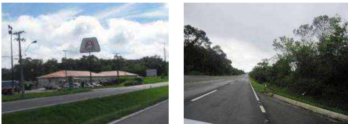
Figura 4.3.2.3-8: Vistas dos sistemas de drenagem pluvial da BR-277 e da PR-508.
