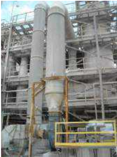
Figura 2.16: Vista geral do lavador de gases da acidulação.
