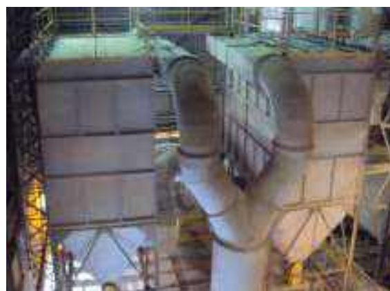
Figura 2.2.3.3-8: Vista do detalhe dos dutos e Filtros de Mangas para os gases do Resfriador
