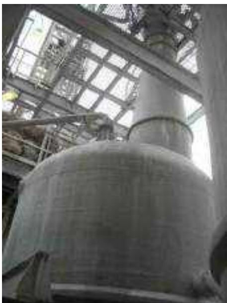
Figura 2.2.5.2-30: Vista da descarga do Lavador Venturi para o Separador de Gotas – Primeiro estágio de lavagem
