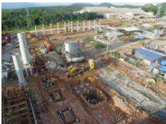
Figura 2.2.4.1-11: Construção e início de montagem da Unidade de Conversão de Enxofre (mar/2008).
