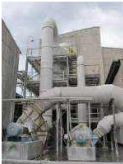
Figura 2.20: Vista geral dos corpos lavadores e exaustores para os gases do granulador e secador.
