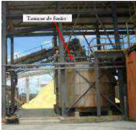
Figura 2.7: Tanque de fusão
