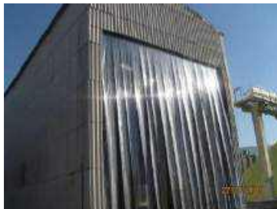
Figura 2.2.5.2-2: Vista do detalhe das cortinas instaladas na entrada e saída do prédio da descarga de enxofre
