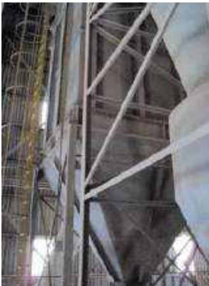
Figura 2.2.5.2-23: Vista do detalhe de um dos filtros de mangas da área da moagem (moinhos)
