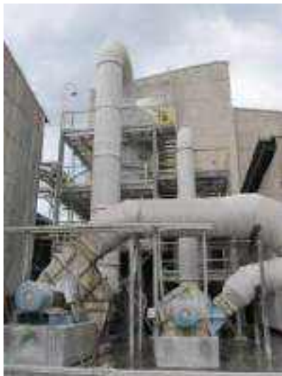
Figura 3.20: Vista geral dos corpos lavadores e exaustores para os gases do granulador e secador.
