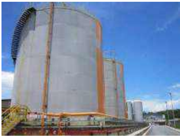
Figura 3.10: Tanques de armazenamento de ácido sulfúrico
