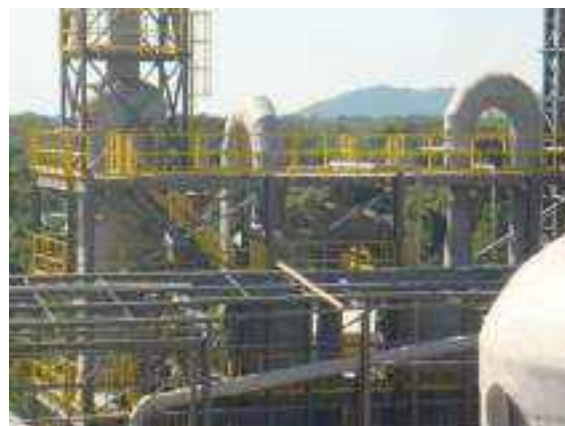
Figura 2.2.4.1-12: Implantação do lavador de gases da Acidulação (jul/2008).
