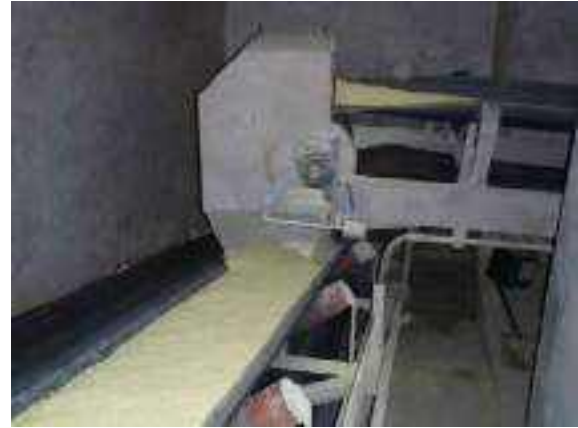
Figura 2.2.5.2-6: Ponto de transferência entre correias transportadoras de enxofre em túnel de concreto.
