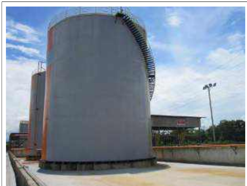
Figura 3.12: Detalhe do dique de contenção dos tanques de armazenamento de ácido sulfúrico
