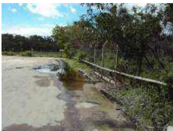
Figura 2.5.4-1: Águas provenientes de área contígua, encaminhadas para o sistema de drenagem do empreendimento
