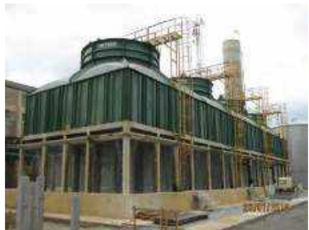
Figura 2.11: Torre de resfriamento da unidade de sulfúrico
