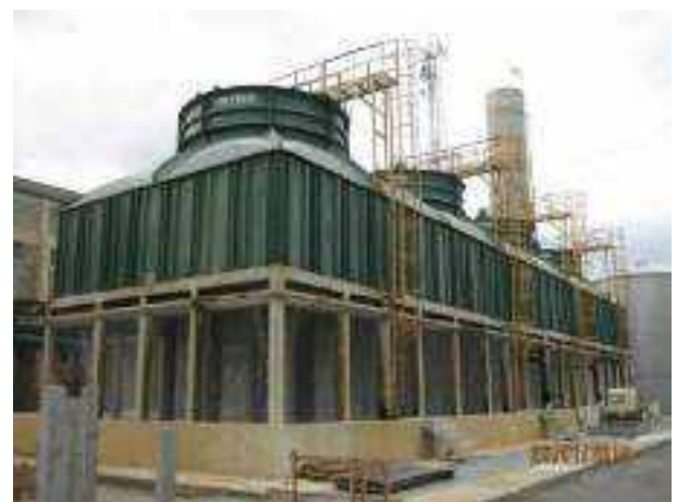
Figura 2.11: Torre de resfriamento da unidade de sulfúrico
