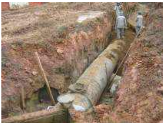
Figura 2.2.4.2-5: Vista da construção das redes de drenagem definitivas da área do empreendimento (jan/2008).
