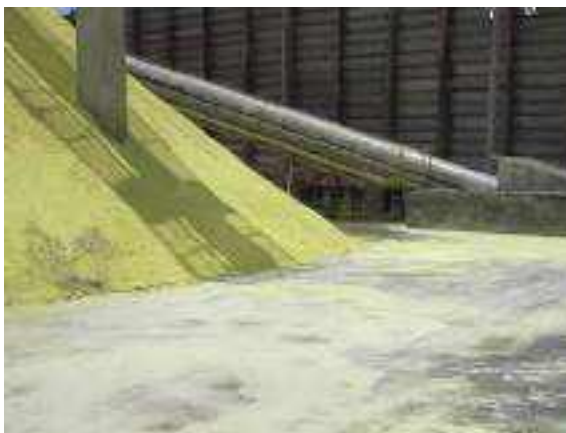
Figura 2.2.5.2-7: Vista da correia transportadora de enxofre enclausurada na saída do em túnel de concreto evitando emissões
