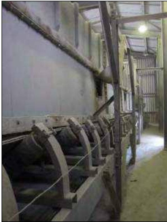
Figura 2.15: Detalhe de uma parte da correia de reação na área de acidulação.
