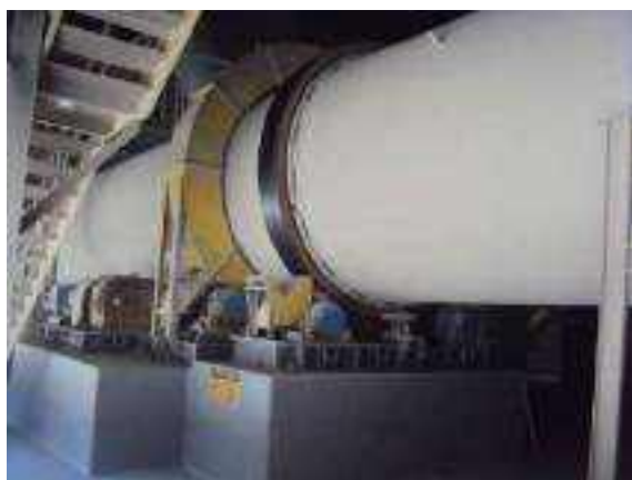
Figura 2.2.3.3-3: Vista geral do secador rotativo
