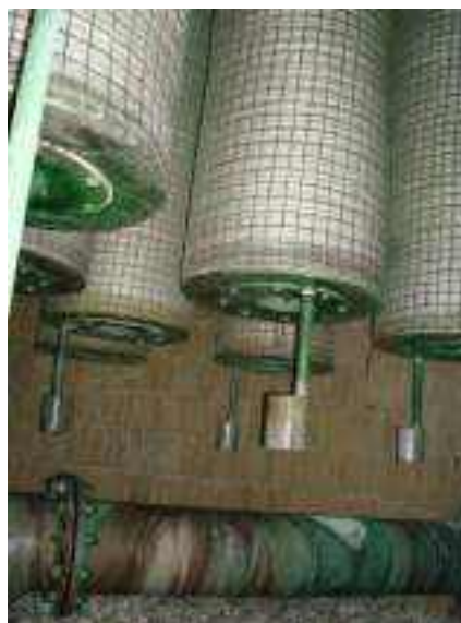
Figura 2.2.5.2-13: Distribuidor e recheio cerâmico das Torres de Absorção.
